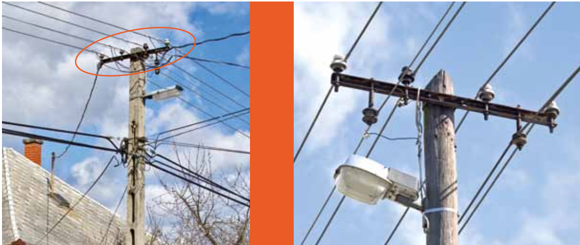
kisfeszültségű csupasz vezeték lecsatlakozással
